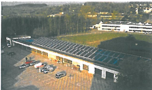
Kollektorfeld (S-Power Vakuumröhrenkollektoren) der solaren Kühlungsanlage bei der Telekom Rottweil (Kollektoren S-Power)
